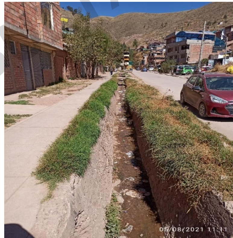
Imagen N° 80: Canalización del curso de agua de la quebrada del ámbito de la ZRESA06
