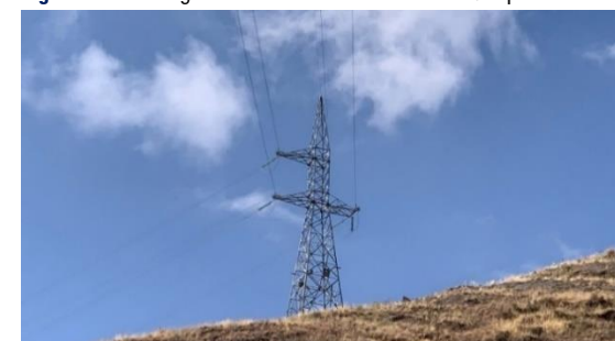
Imagen N° 53: Fotografía de la línea de alta tensión Quenqoro-Dolorespata
