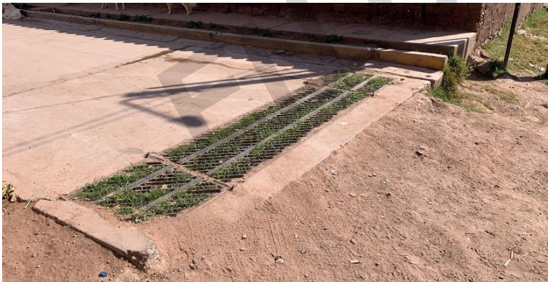
Imagen N° 58: Fotografía de sumidero con rejilla de agua pluvial sin mantenimiento
