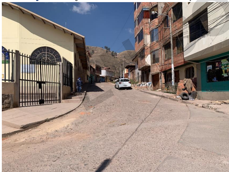
Imagen N° 15: Fotografía "Calle 3" en estado de conservación muy malo
