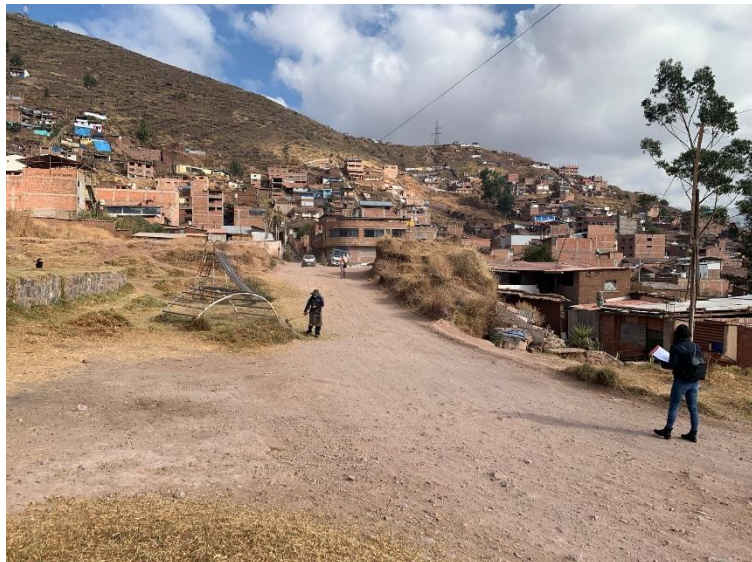
Imagen N° 14: Fotografía "Av. 28 de Julio", con estado de conservación muy malo
