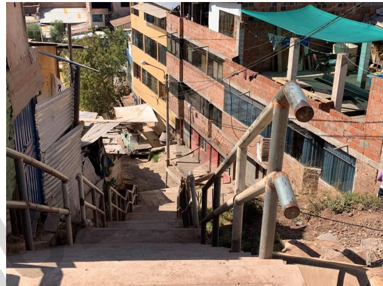
Imagen N° 16: Fotografía "Pasaje S/N 02" en estado de conservación malo
