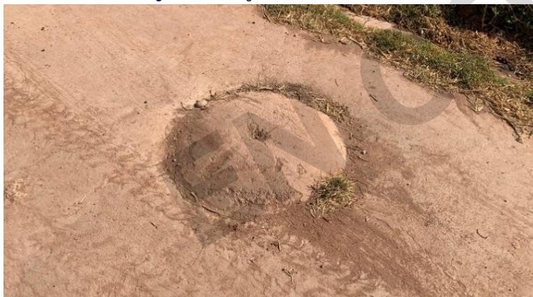
Imagen N° 51: Fotografía de buzón sedimentado
